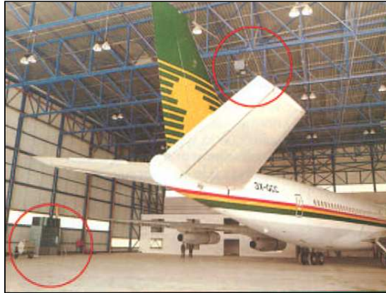
Générateur d'air chaud et déstratificateur
