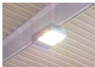
Luminaire à 2 lampes (vapeur de mercure et vapeur de sodium)
