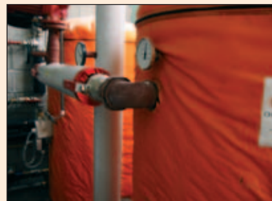
Des capteurs sont installés sur les ballons de stockage
