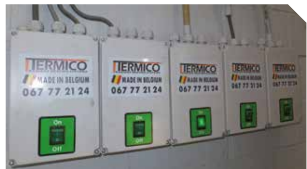
Via ces 4 "interrupteurs", 4 zones du site peuvent être chauffées indépendamment en fonction des besoins (activité / présence de personnes)
