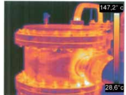
Tête d'un générateur de vapeur propre isolée
