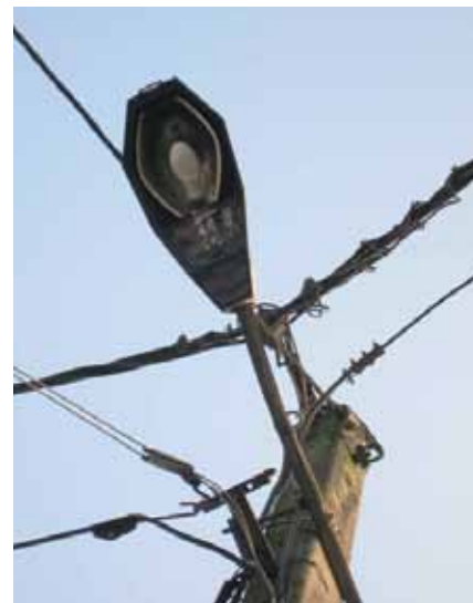
Installées dans les années 60, les lampes à vapeur de mercure ont été progressivement remplacées par les lampes à vapeur de sodium.
