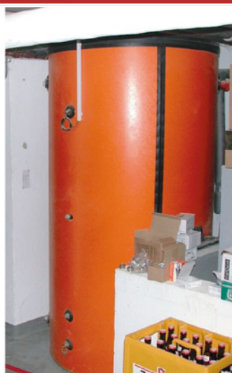
Figure : L'intérieur de la \mu -cogen Senertec de 5.3 kW e et 10.5 kW th – Ballon de stockage de l'eau de chauffage de 1 000 litres Crédit photo : ICEDD
