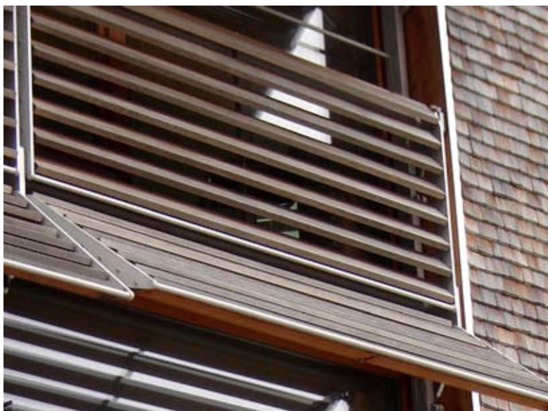
(Doc. ICEDD) Protections solaires pour réduire les apports solaires estivaux
