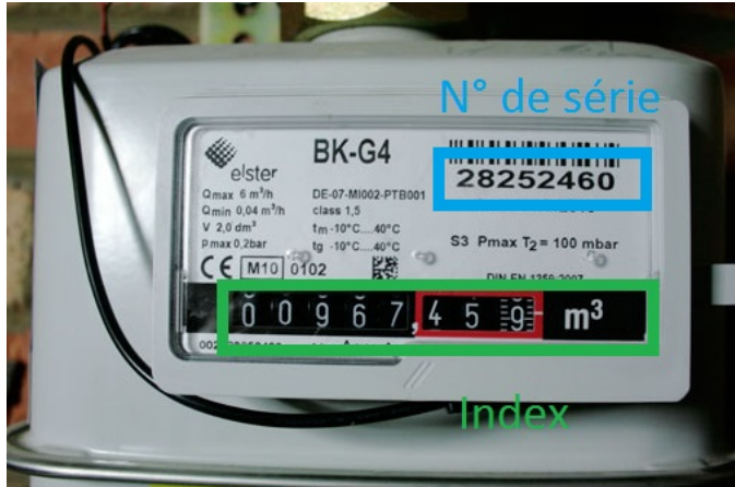
Figure 6 Exemple d'un compteur de gaz cogénération Elster . La valeur de l'index est de 967,459 \text{m}^3 .
