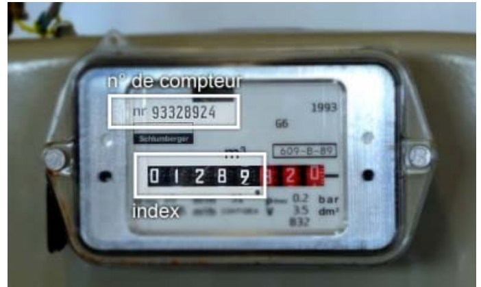
Figure 3 Exemple d'un compteur gaz réseau dont l'index vaut 1289,82 m^3 .
