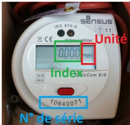
Figure 7 Exemple d'un compteur thermique Sensus en MWh. La valeur de l'index est 0,000 MWh, les décimales sont soulignées.
