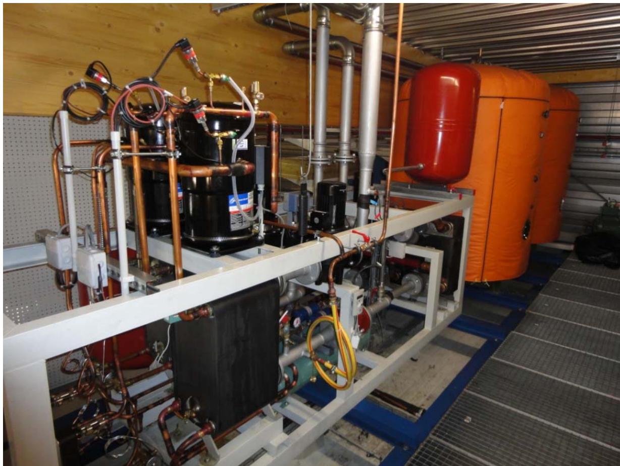
Photo 1 - Pompe à chaleur et réservoirs d'eau chaude | Source : Navitas
