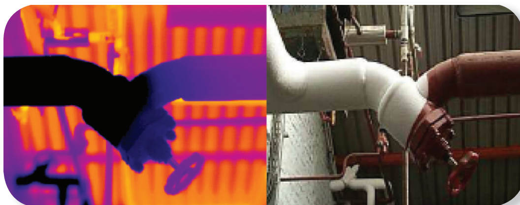
Vanne ammoniacale bien hermétique - Source : Anatherm Thermographie Infrarouge
