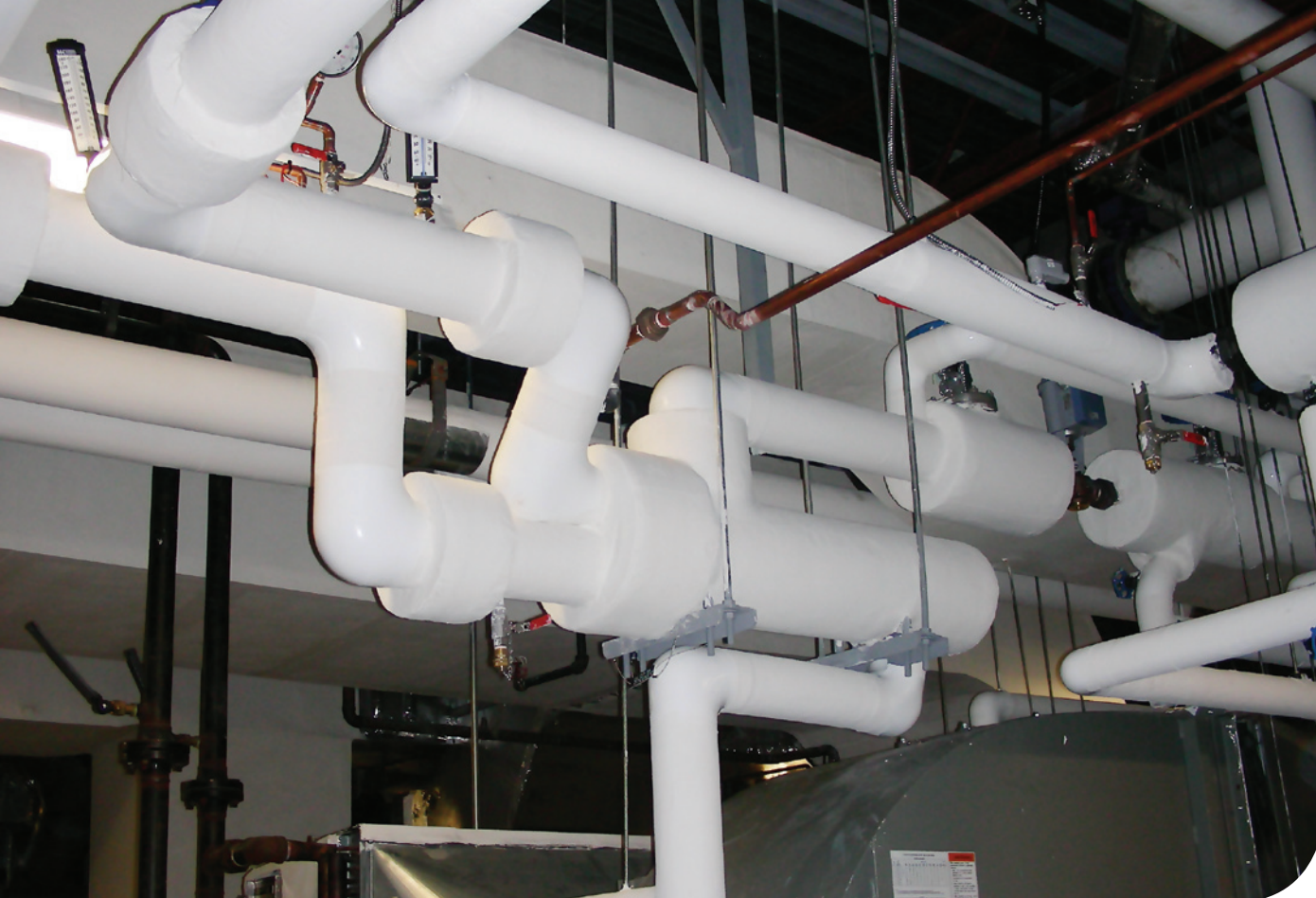
Calorifugeage. Source : coteisolation.fr
