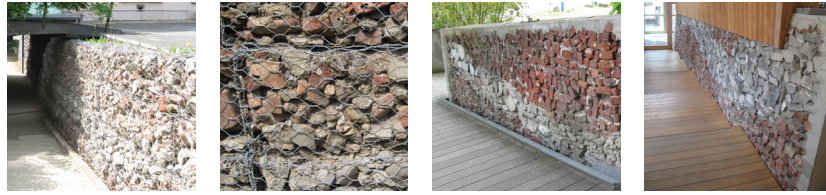
Utilisation de matériaux inertes issus des démolitions dans le bâtiment de l'espace kegeljan à Namur.
