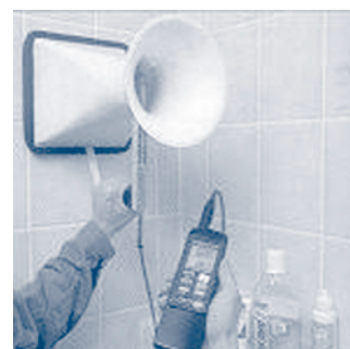
MESURE DU DÉBIT AU DROIT D'UNE BOUCHE
