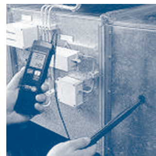
MESURE DU DÉBIT DANS UNE GAINÉ
