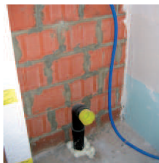
Zone non plafonnée en fond de local sanitaire attendant la pose d'un wc suspendu et d'une contre cloison, Source CSTC
