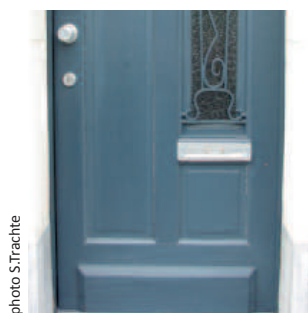
Boîte aux lettres non étanches dans une porte d'entrée
