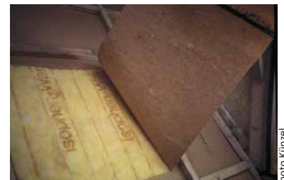
Moisissures à l'arrière de la membrane de régulation de vapeur d'eau
