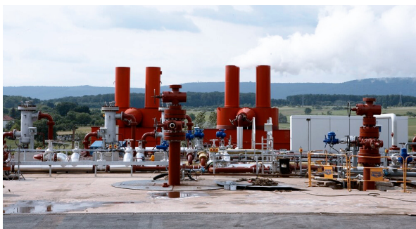
Figure 4: Centrale Géothermique de Soultz-sous-Forêts
