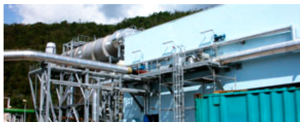
Figure 6: Centrale géothermique de Bouillante (Guadeloupe, France)
