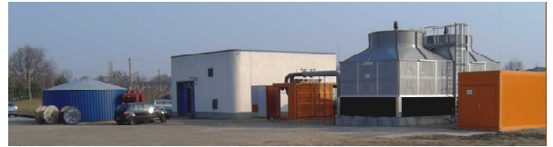
Figure 8: Centrale binaire de Neustadt-Glewe (Allemagne)
