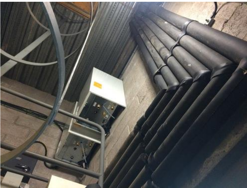
Figure 9: Tuyauterie isolée dédiée au réseau de chauffage, avec le système de back-up constitué d'une chaudière à gaz.
