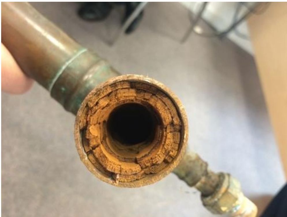
Figure 10: Accumulation de dépôts (scaling) dans les canalisations après dix ans. Le nettoyage périodique permet désormais de maintenir les débits.
