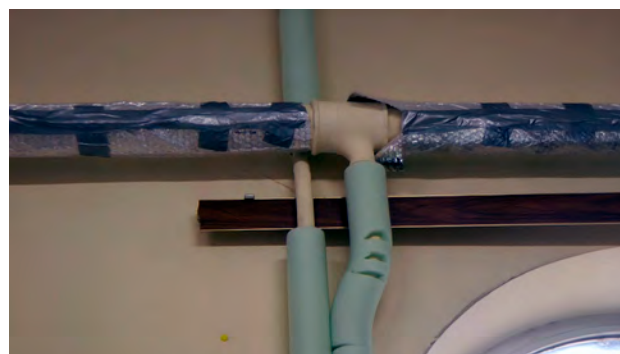
Isolation des tuyaux et vannes - Images : Sylvie Rouche
