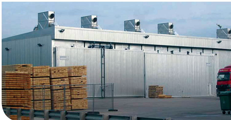
Cellules BES-Bollmann avec récupérateurs de chaleur.
