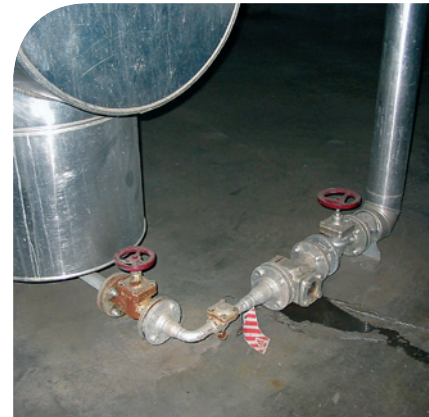
Fuite de condensats au niveau d'un purgeur.
