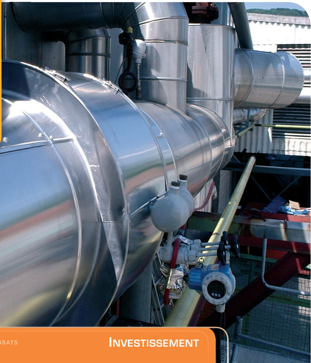
Débitmètre vapeur de type delta p. Source : Endress & Hauser
