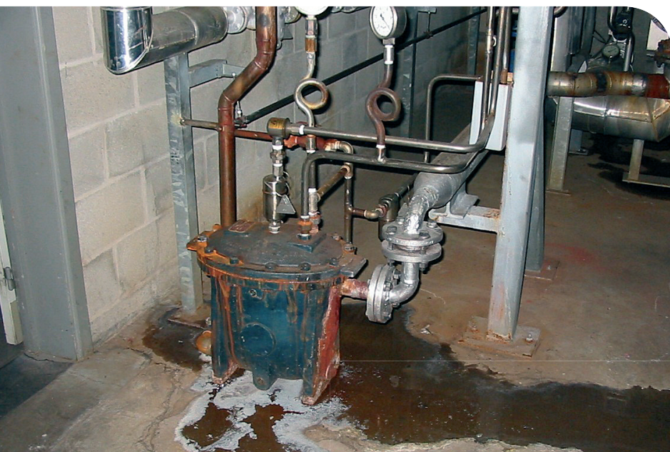
Fuite de condensats au niveau d'une pompe.
