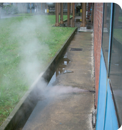
Fuite vapeur. Source : Armstrong
