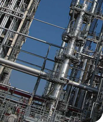
Détail des installations du site "Total Petrochemicals" à Feluy. Source : planete-energies
