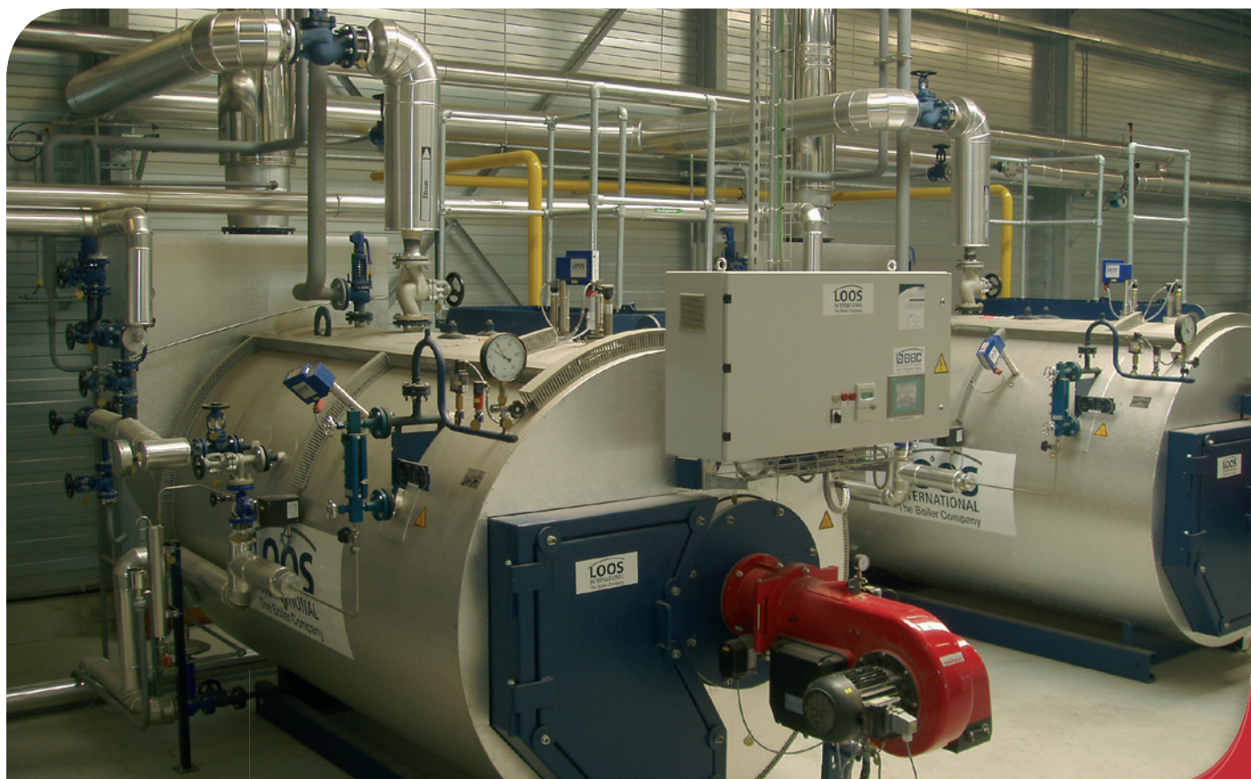
Chaudières à tubes de fumée 2x2 t/h. Source : BBC Loos
