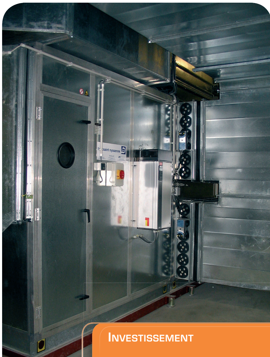
Variateur de vitesse sur groupe HVAC. Source : BRU.
