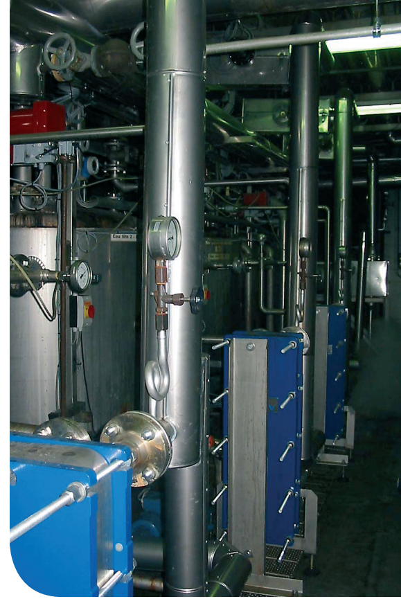
Nouveaux échangeurs à plaques.
