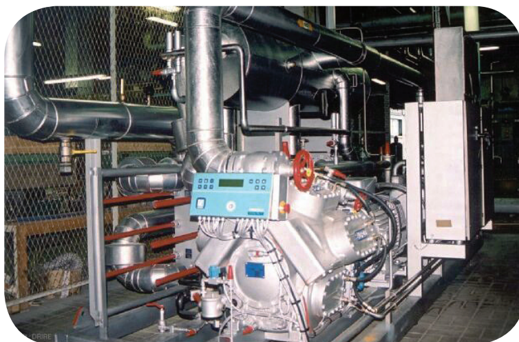
Compresseur de Réfrigération. Source : DRIRE
