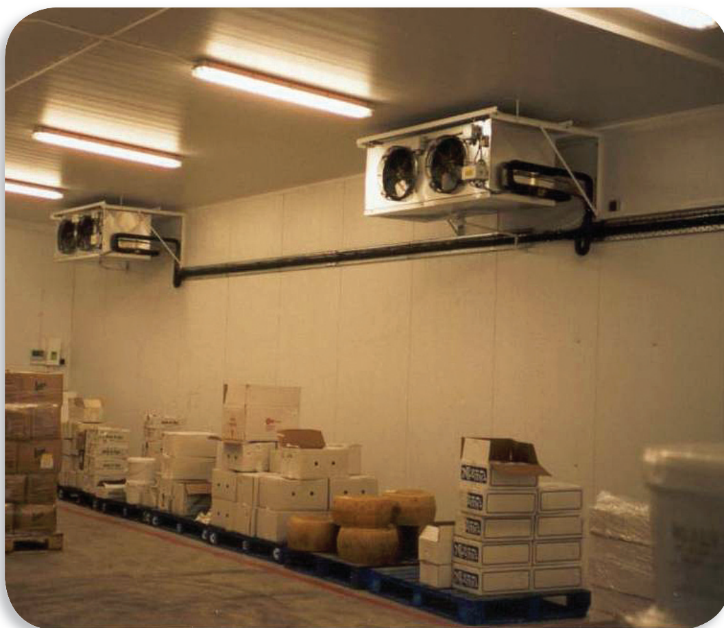
Chambre froide. Source : Copeland
