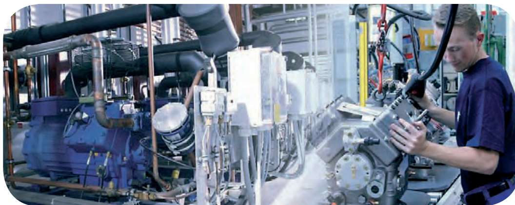
Maintenance d'un groupe de compression. Source : BOCK.
